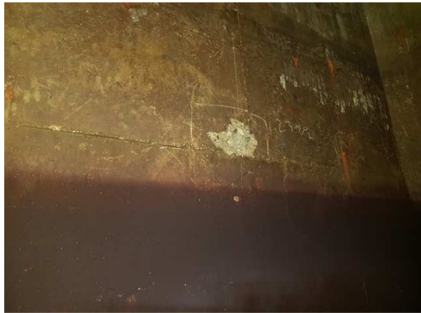
내용 벽체부 파손
