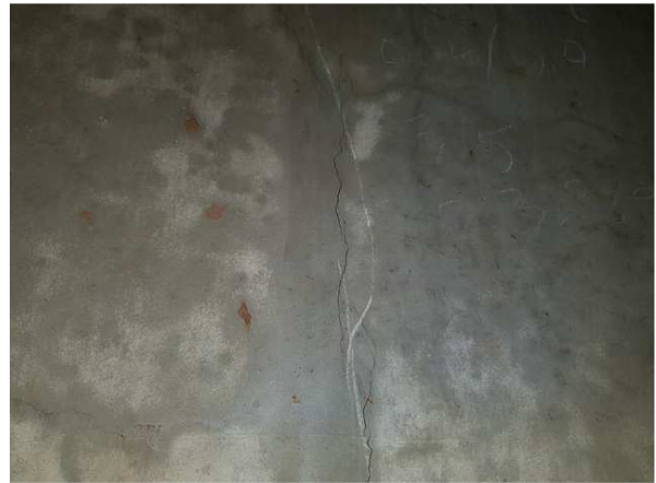
내용 벽체부 균열(0.3mm이상)
