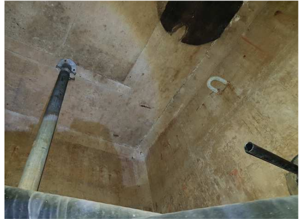
내용 상부슬래브 녹흔적
