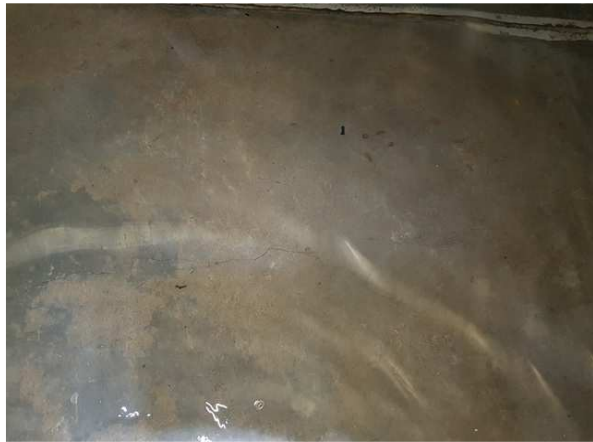
내용 벽체부 균열(0.3mm미만)
