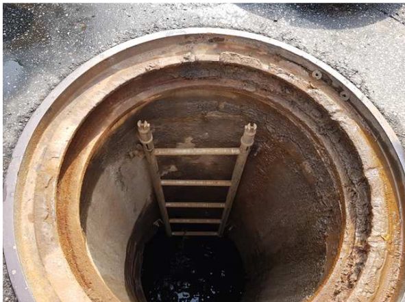
내용 안전손잡이 파손
