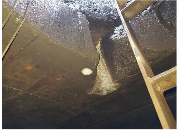
내용 상부슬래브 백태
