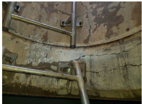
내용 상부슬래브 균열(0.3mm이상)
