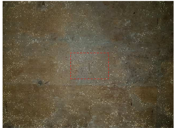
내용 상부슬래브 녹흔적
