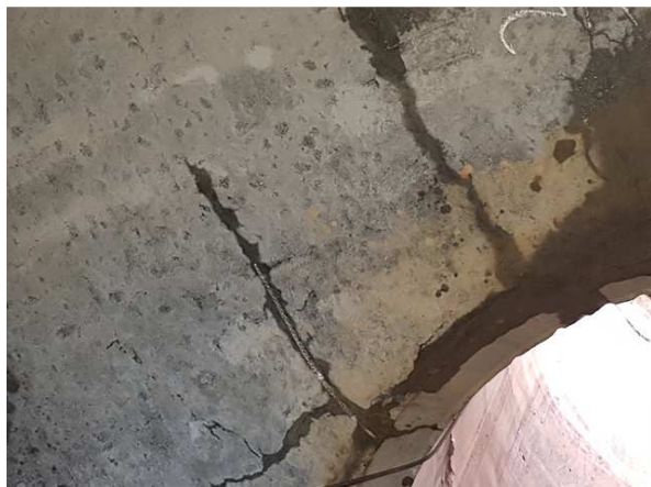
내용 상부슬래브 균열(0.3mm미만)
